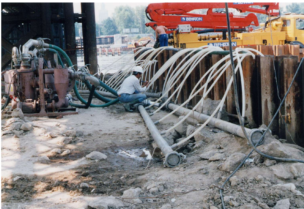
Rys. 6. Instalacja chłodząca na fundamencie pylonu Mostu Świętokrzyskiego
